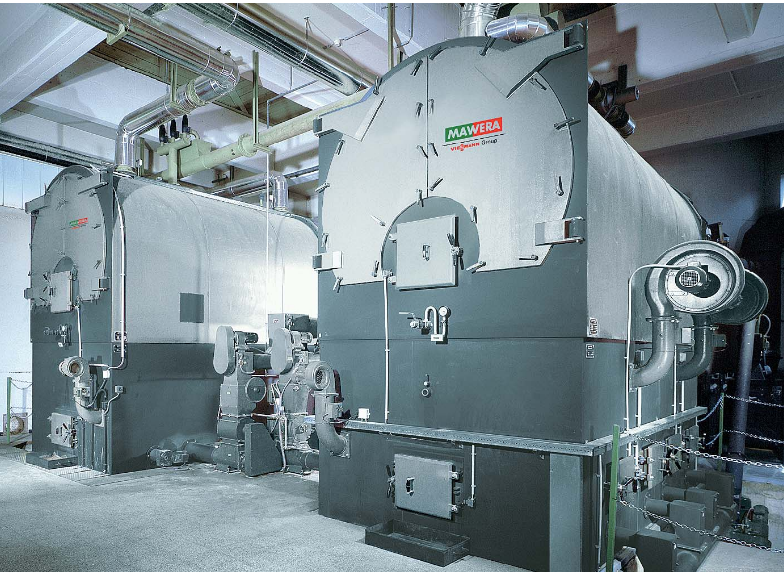
2 x podsvně spalování FU 2 500 RA, Mosser Leimholzbau, Randegg, Rakousko
