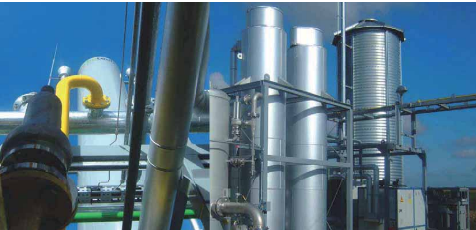
Úprava bioplynu Emmertsbühl/Blaufelden
