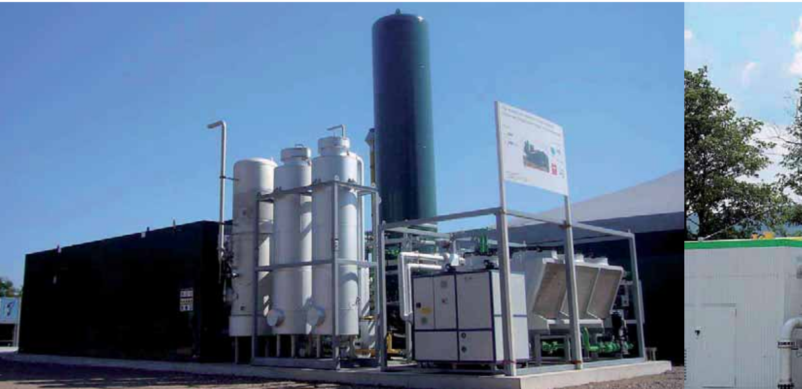
Zařízení na úpravu bioplynu Wüstring/Oldenburger, Ostfriesland
