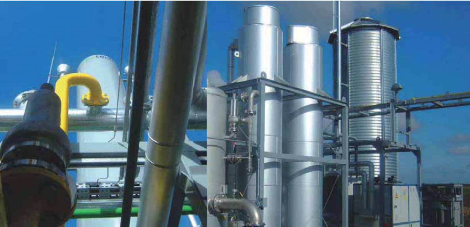
Úprava bioplynu Emmertsbühl/Blaufelden
