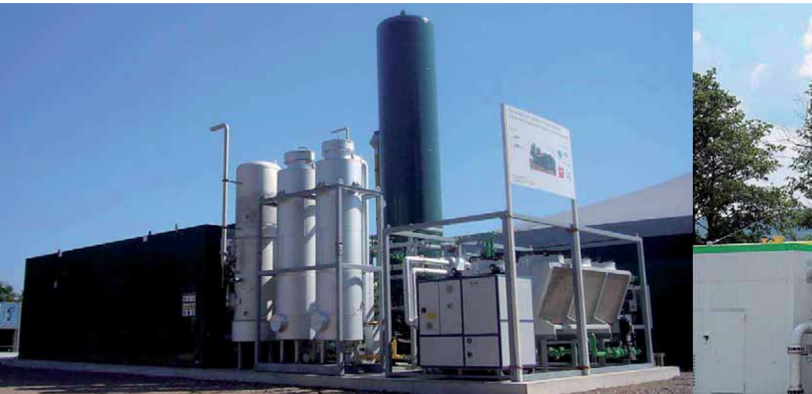
Zařízení na úpravu bioplynu Wüstring/Oldenburger, Ostfriesland
